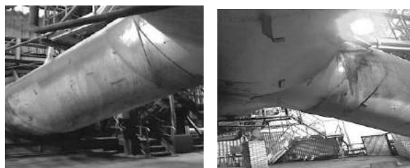
Рис. 5. Подвод горячего дутья к кольцевому воздухопроводу: А – вид слева; Б – вид справа
