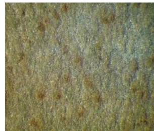
Рис. 1. Очаги питтинговой коррозии на поверхности горячекатаного проката
