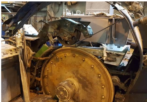
Рис. 1. Смонтированный на стане индуктор электромагнитного модификатора
